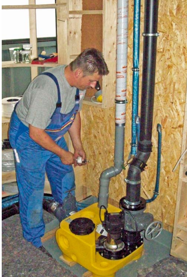
Da der Platz knapp ist, müssen kompakte Hebeanlagen eingesetzt werden, die zuverlässig arbeiten
